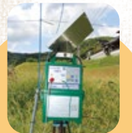
すべての電気柵にバッテリー切れの心配がないソーラーバッテリーを使用
