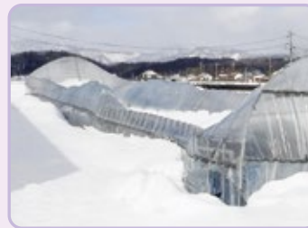
大雪で陥没したハウス
