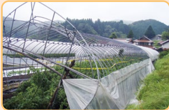
強風で被覆材が破れ、本体が変形したハウス
