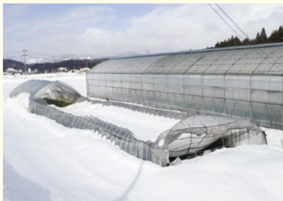
積雪により倒壊したハウス
