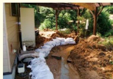
土砂崩れの被害にあった建物
