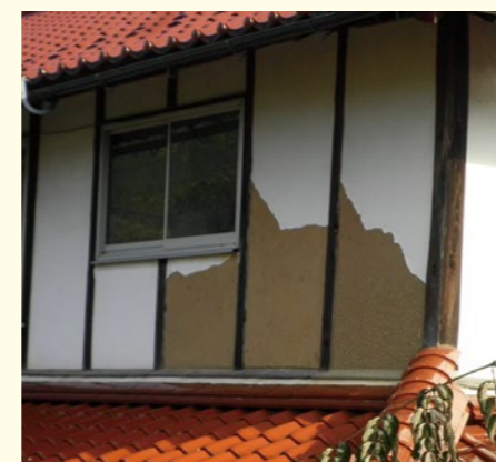
台風による外壁の剥離
