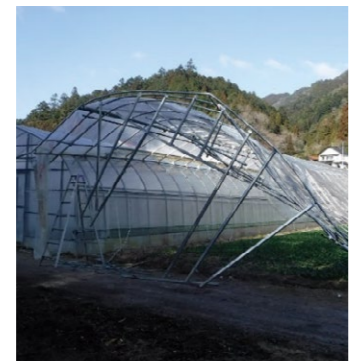
強風で全壊したハウス
